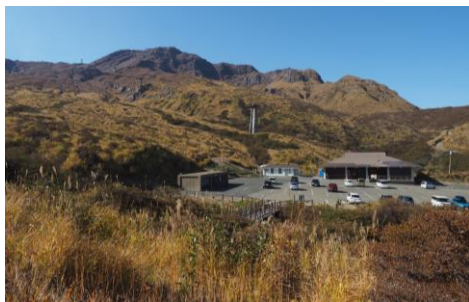
仙酔峡の駐車場。古いロープウェイの支柱だけ残っている。駅舎の取り壊し工事中。
